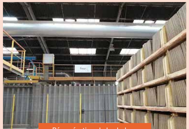
Récupération de la chaleur du four pour le séchoir
